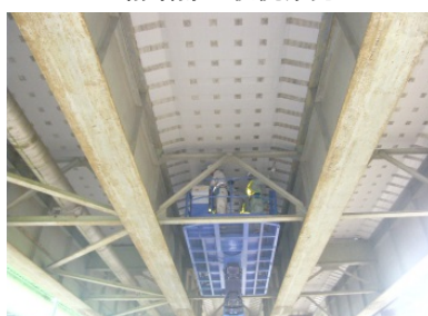
▲主桁の腐食状況確認
