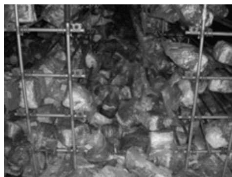
写真-4 きのこ生産施設の被害
