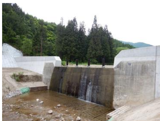
治山事業の実施（流木捕捉施設）
