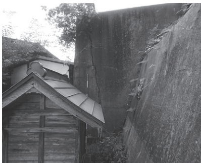
既設の土留工に生じた 大きなひび割れ(東松島市関田)
