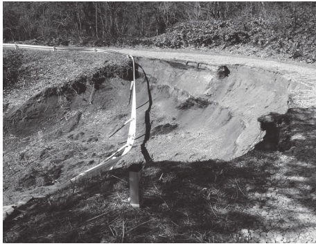
加美町「鼠堂線」被災状況
