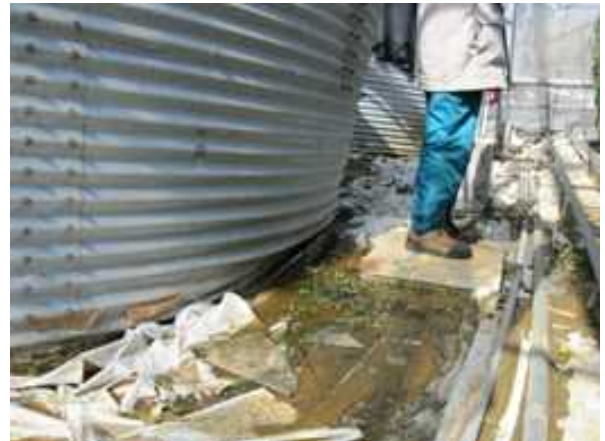
雨水貯蔵用タンク破損し、雨水流出、施設内一部浸水。
