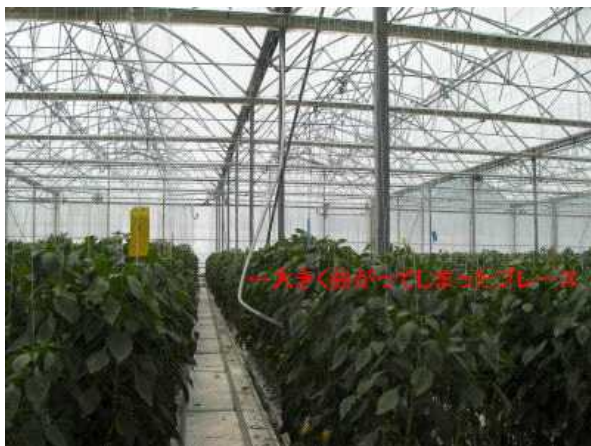
パプリカの栽培施設の被害（栗原市） ※大きく曲がったブレース（H23.6.22 撮影）
