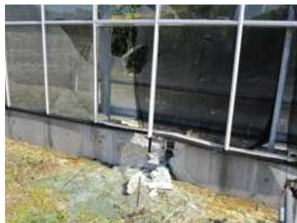
外壁用ガラス、基礎等が破損。
