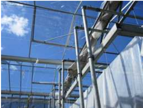
天窗用ガラス破損。
