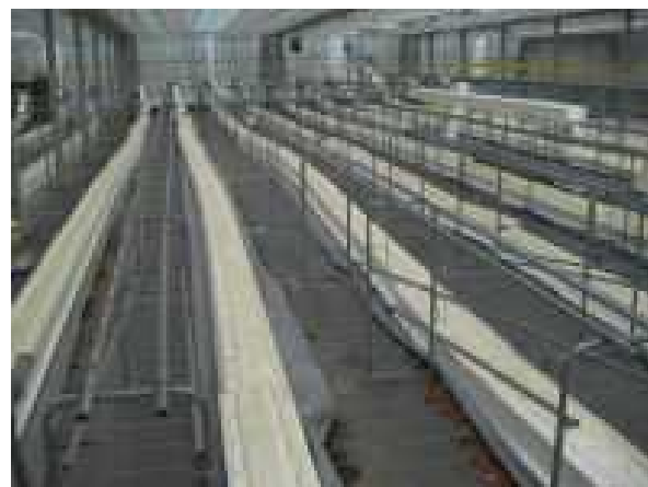
イチゴの栽培施設の被害（石巻市） ※転倒・落下した高設ベンチ。（H23.6.24 撮影）
