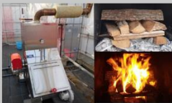
木質バイオマスボイラーと燃焼室での薪の燃焼状況(右)
