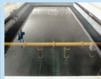
⑧急速ろ過池
