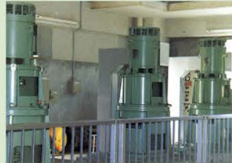
③取水ポンプ場
