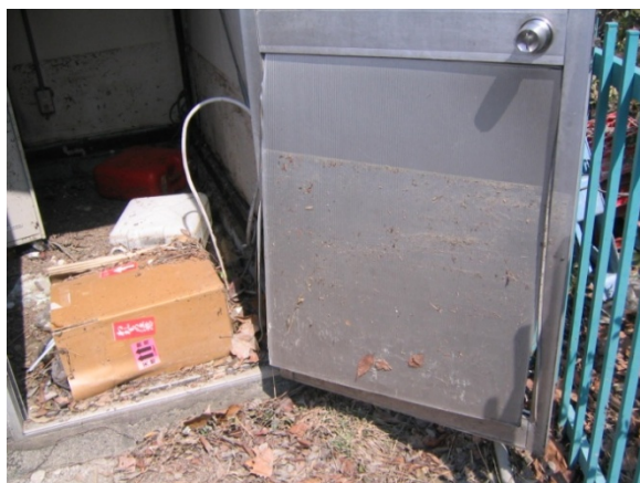
損壊した入口ドア
