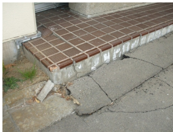
玄関前の沈下
