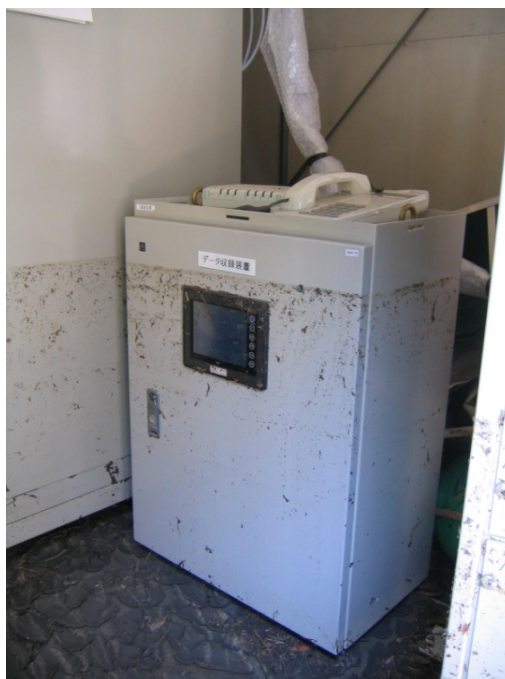
浸水したデータ収録装置
