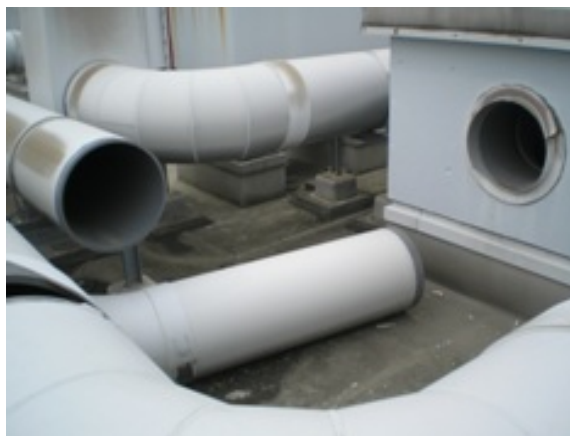
特定化学物質検査棟屋上ダクトの損傷
