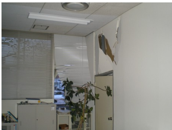
1階所長室壁面の損壊
