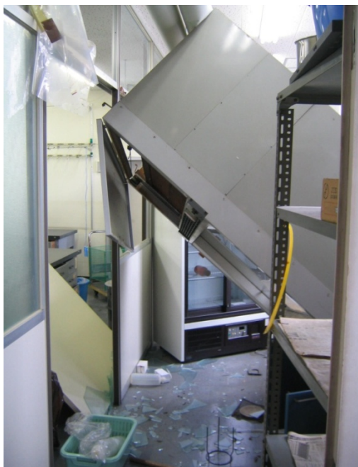
5階ドラフト傾斜破損
