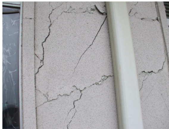
3階ベランダの壁ひび割れ
