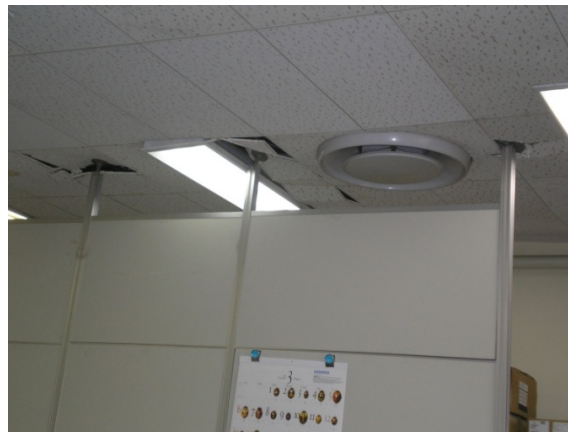
1階テレメータ室天井の損壊
