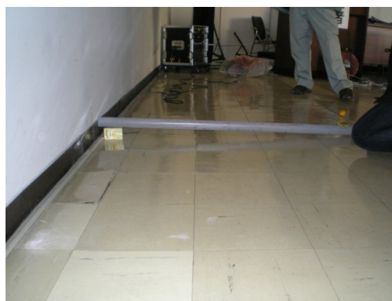
1階大会議室 壁側の床面が沈下し、傾斜
