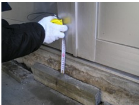
北側出入口の沈下
