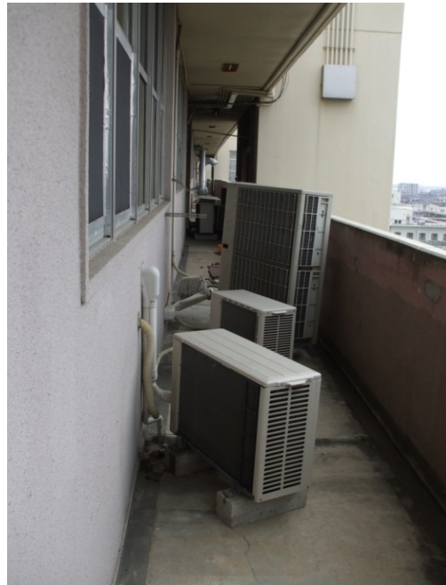
5階ベランダ 室外機移動
