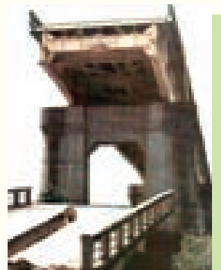
昭和53年の宮城県沖地震による落橋
