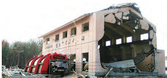
写真 四方が津波で破壊された排水機場建屋
