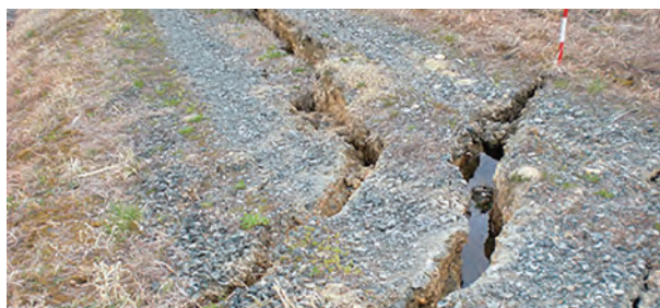
写真 劣化が進んで水が溜まり崩壊した地震災害の亀裂
