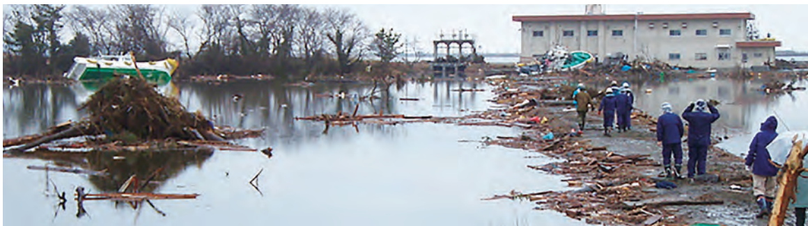
写真1 破壊され瓦礫に埋まる排水機场上流水路
