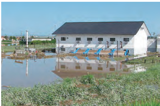
写真 水没した米袋排水機場
