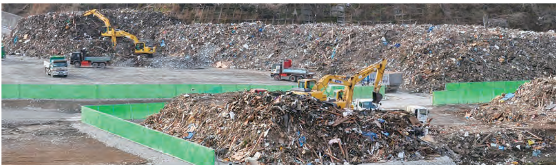
写真 堆積された大量の津波廃棄物
