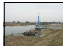
右京江取水工
