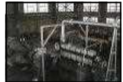
鶴家排水機場 (室内)
