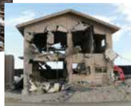
津波による排水機場の被災(山元町)
