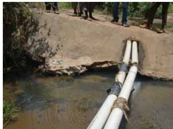
写真 1 4 : 紫外線によるパイプラインの劣化
