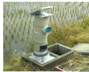
水管理システム (自動給水栓)
