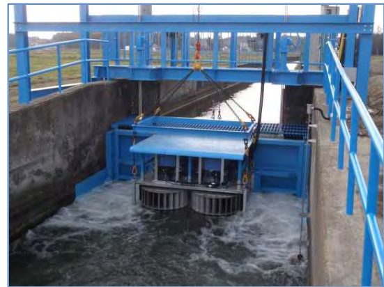
内川小水力発電所(H27.4～発電開始)
