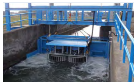
小水力発電施設
