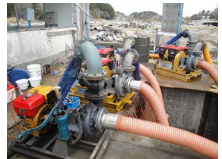
応急ポンプ設置(東松島市)(H23年3月)
