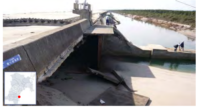
海岸堤防の被災(巨理町) (堤防右側水路は堤防を越流してきた津波によりえぐられた結果できたもの。)
