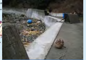
④農地海岸被災状況 (南三陸町：滝浜海岸堤防)
