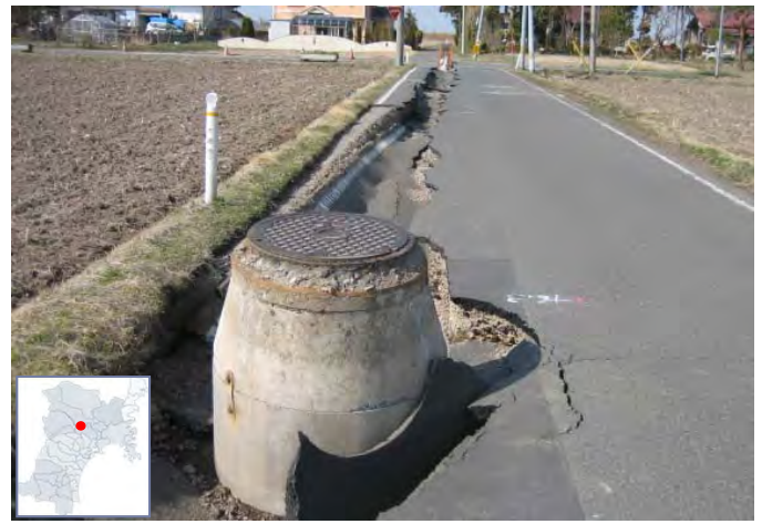
農業集落排水施設の被災(大崎市)
