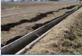
③農地被災状況 (大崎市、加美町：多田川左岸地区)
