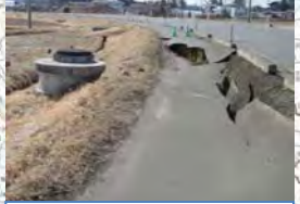
①かんがい排水被災状況 (栗原市：迫川上流地区)
