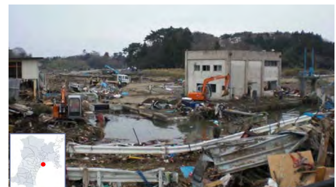
中下排水機場の被災(東松島市)
