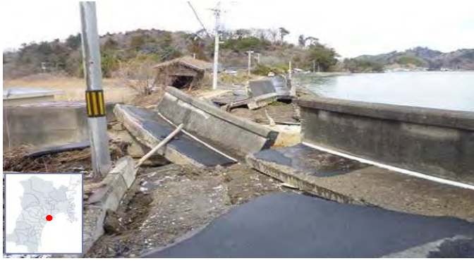
海岸堤防の被災(松島町)
