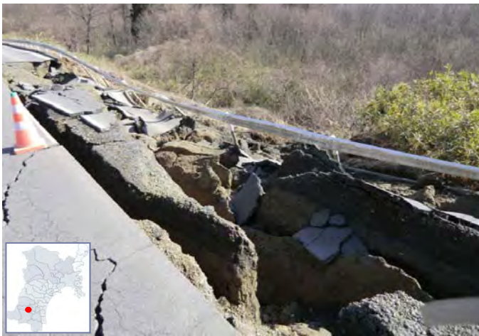
広域農道の被災(蔵王町, 川崎町など)
