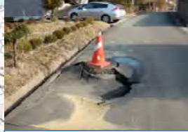
②農業集落排水被災状況 (登米市：新小路地区)
