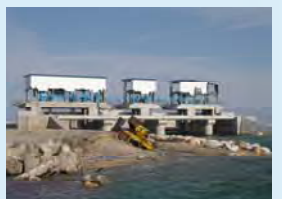
⑭防潮樋門被災状況 (山元町：牛橋防潮樋門)
