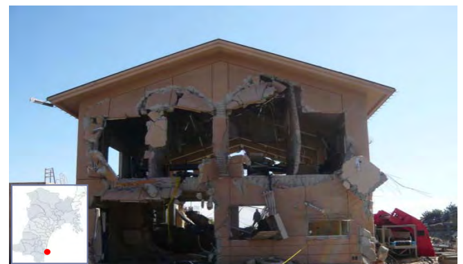
花笠第2排水機場の被災(山元町)
