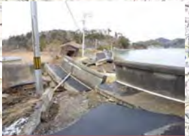
⑧農地海岸堤防被災状況 (松島町：駒形・新田海岸堤防)
