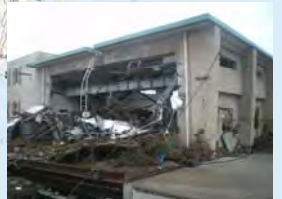
⑩排水機場被災状況 (仙台市：高砂排水機場)
