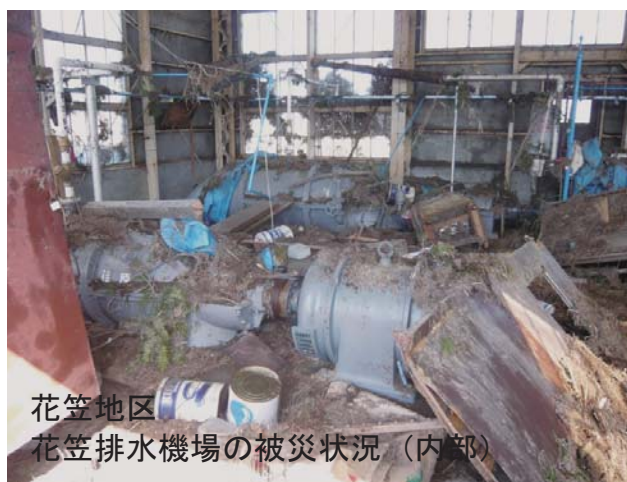
花笠地区 花笠排水機場の被災状況
