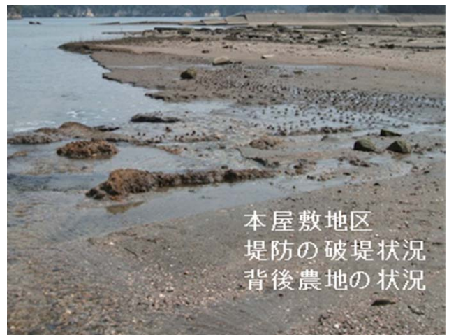
本屋敷地区 貝の浜西地区 堤防の破堤状況
