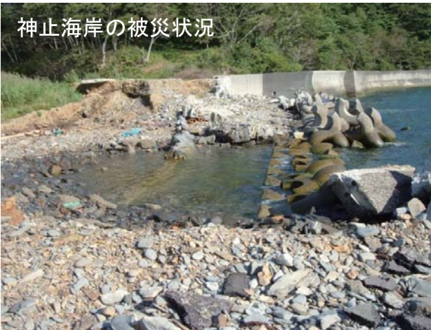
神止海岸の被災状況
