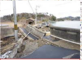
⑧海岸堤防被災状況 (松島町: 駒形・新田海岸堤防)
