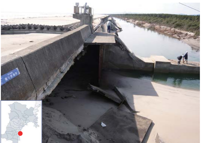
海岸堤防の被災(巨理町)
