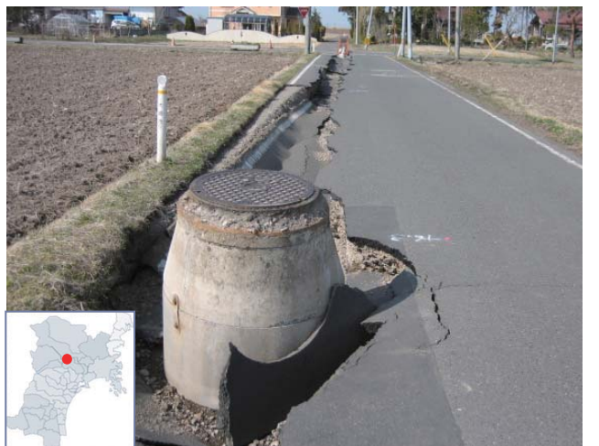
農業集落排水施設の被災(大崎市)
