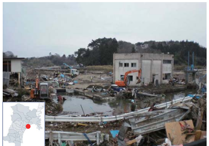
中下排水機場(東松島市)
