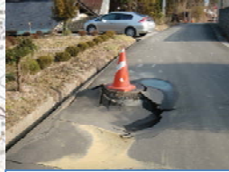
②農業集落排水被災状況 (登米市: 新小路地区)
