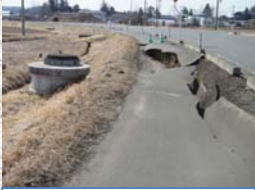
①かんがい排水被災状況 (栗原市: 迫川上流地区)
