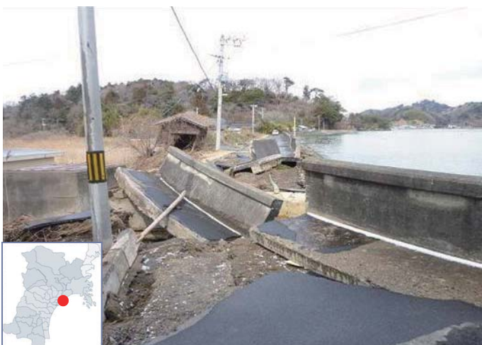
海岸堤防の被災(松島町)
