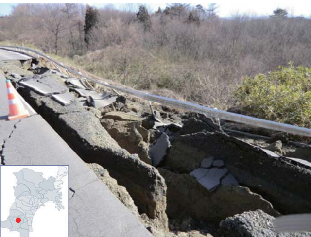
広域農道の被災(蔵王町, 川崎町など)
