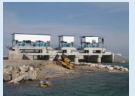
⑭防潮種門被災状況 (山元町: 牛橋地区)
