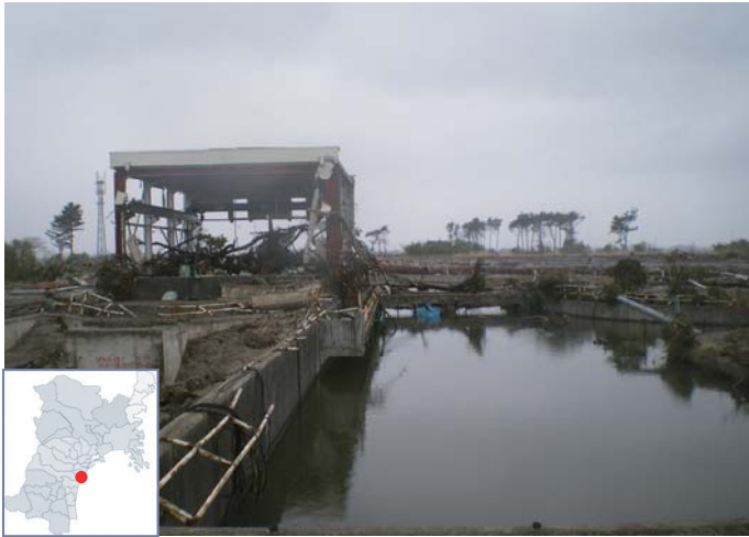
大堀排水機場(仙台市若林区)
