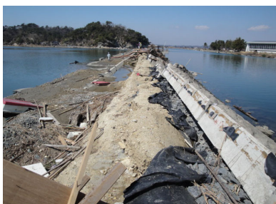
①被災状況(H23.3)
