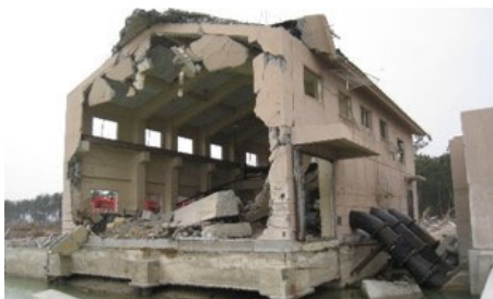
①被災状況(H23.3)
