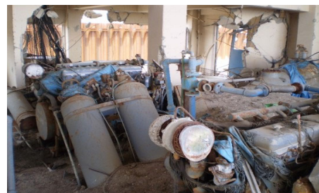
②被災状況(H23.3)
