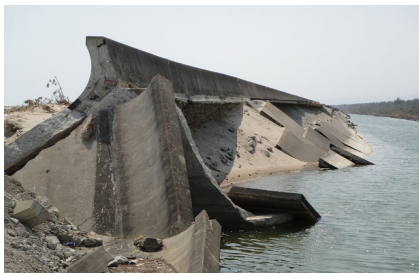
①被災状況(H23.3)
