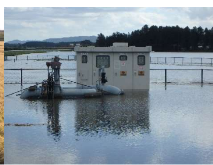
△揚水機場の浸水
