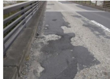
(旧志田橋)橋面の劣化状況
