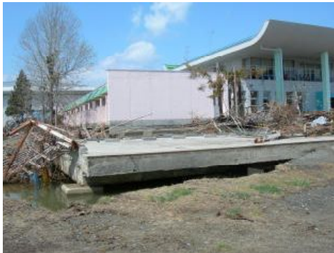
[本館前の地盤沈下]
