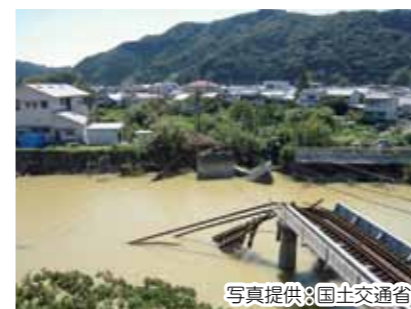
和歌山、奈良県台風第12号 【2011(平成23)年8月30日~9月5日】
