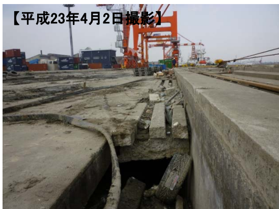
クレーン基礎間沈下及び空洞化状況 高砂2号(-14m)
