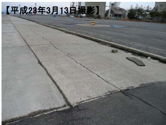
エプロンと埠頭用地の段差状況 中野2・3号(-10m)
