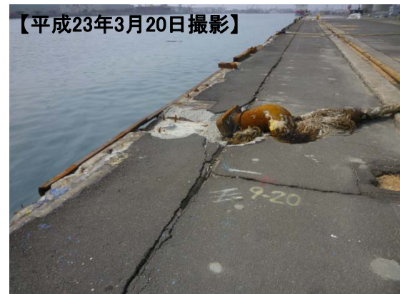
車止め及び係船曲柱の被災状況 中野1号(-12m)
