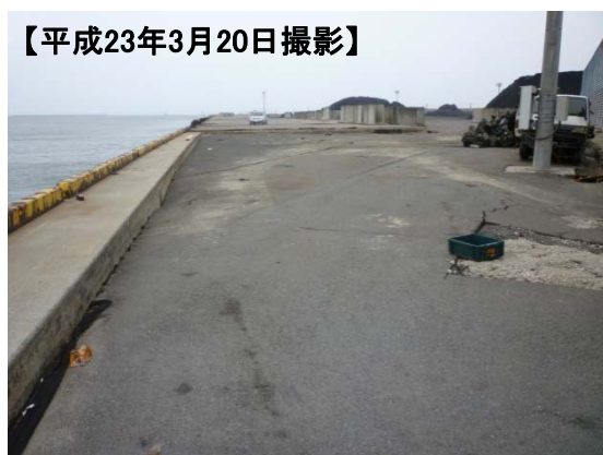
エプロンと埠頭用地の段差状況 向洋(-12m)
