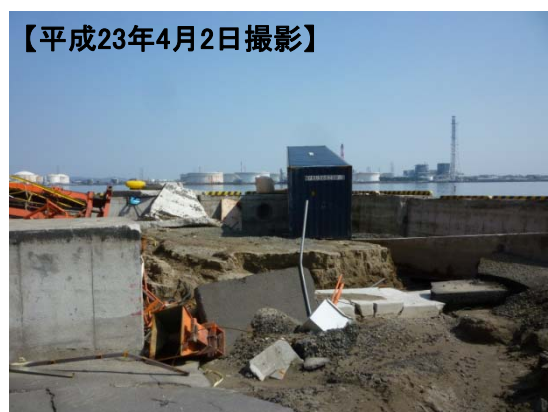
沖側取付部沈下・吸い出し状況 高砂2号(-14m)
