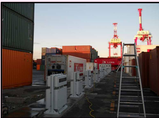
平成23年12月9日 増設したリーファー電源
