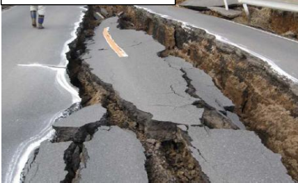
迫川 堤防縦断亀裂
