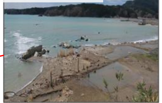
中島地区海岸被災状況
