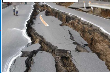
迫川 被災状況
