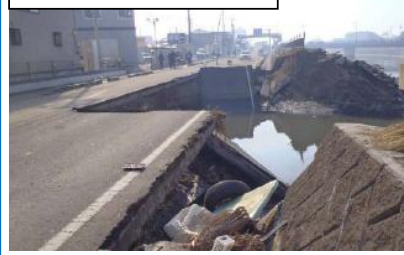
砂押川 被災状況
