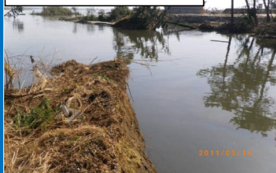
七北田川 被災状況
