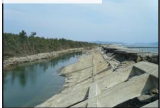
大曲地区海岸被災状況
