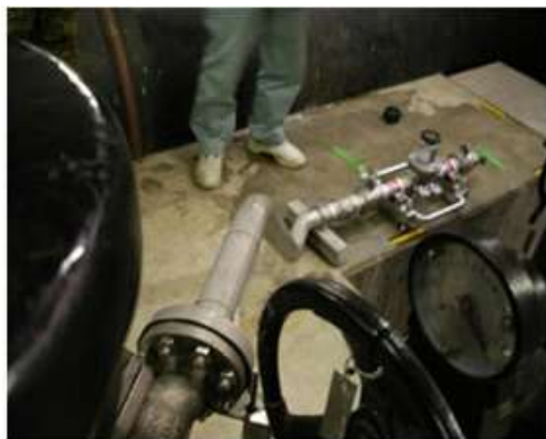
減圧弁設置状況
