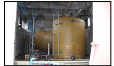
⑤消毒設備(水没・タンク倒壊)
