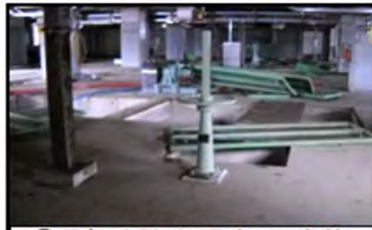
②最初沈殿池(浸水・泥堆積)
