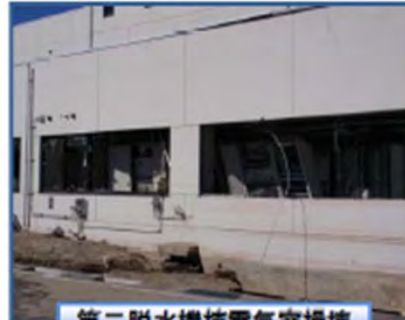
第二脱水機棟電気室損壊
