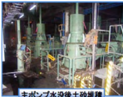
主ポンプ水没後土砂堆積
