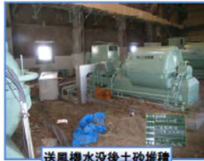
送風機水没後土砂堆積
