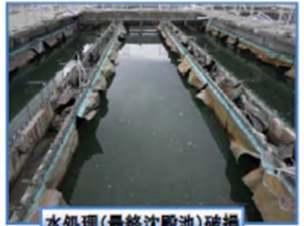
水処理(最終沈殿池)破壊
