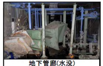
地下管廊(水没)
