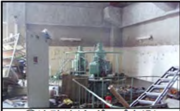
①沈砂池(主ポンプ水没)
