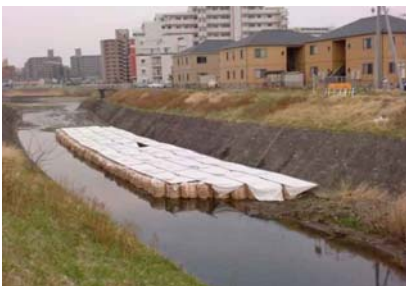
要害川 仮設沈殿池【写真】
