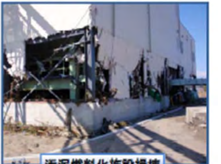
汚泥燃料化施設損壊
