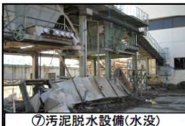
⑦汚泥脱水設備(水没)
