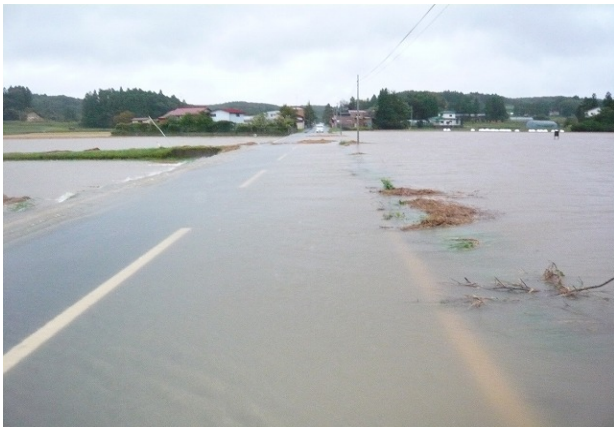
市道冠水（栗原市築館中太田地内）
