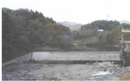
茂庭発電所取水堰(名取川)
