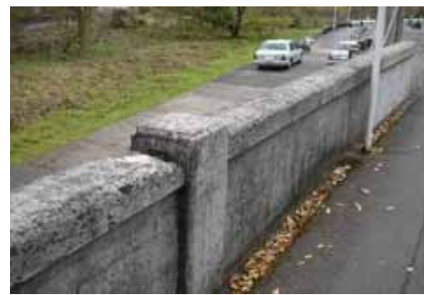
かたん 花壇自動車学校前の堤防の損傷・劣化状況
