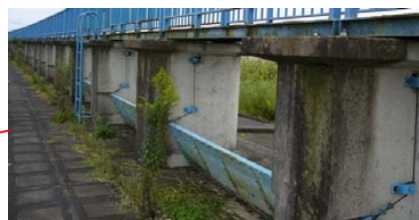
南谷地越流堤施設の老朽化状況
