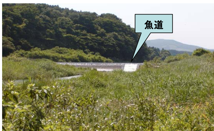
図 1-28 魚の遡上が阻害されている一例（鳴瀬川掃留堰堤）
