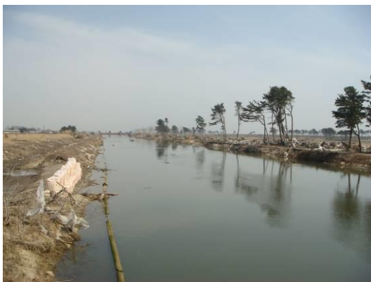
堤防の被災・流出 (南貞山運河)
