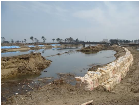
被災した堤防（五間堀川）
