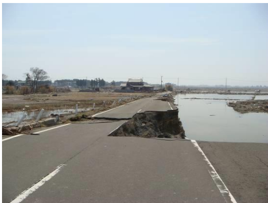
被災した橋梁（五間堀川）
