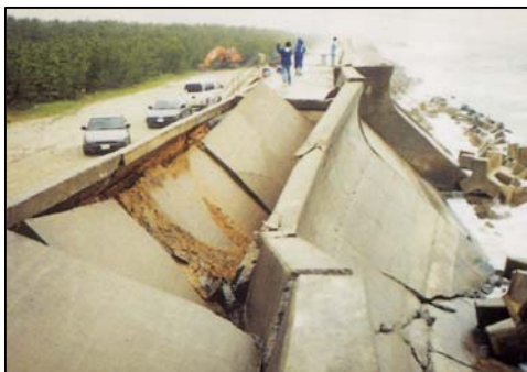
堤防の被災状況（山元町）
