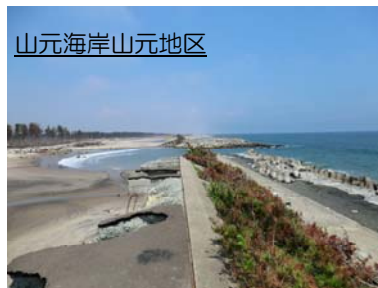
堤防の被災状況(山元町)
