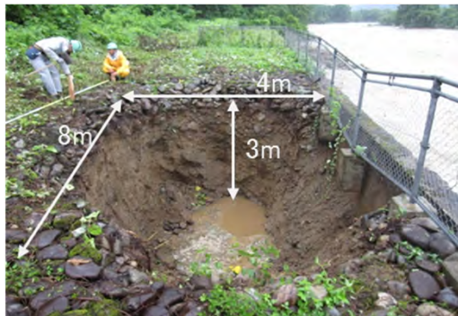
頭首工側壁の脇では高水敷が陥没
