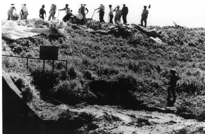
川裏法面漏水
