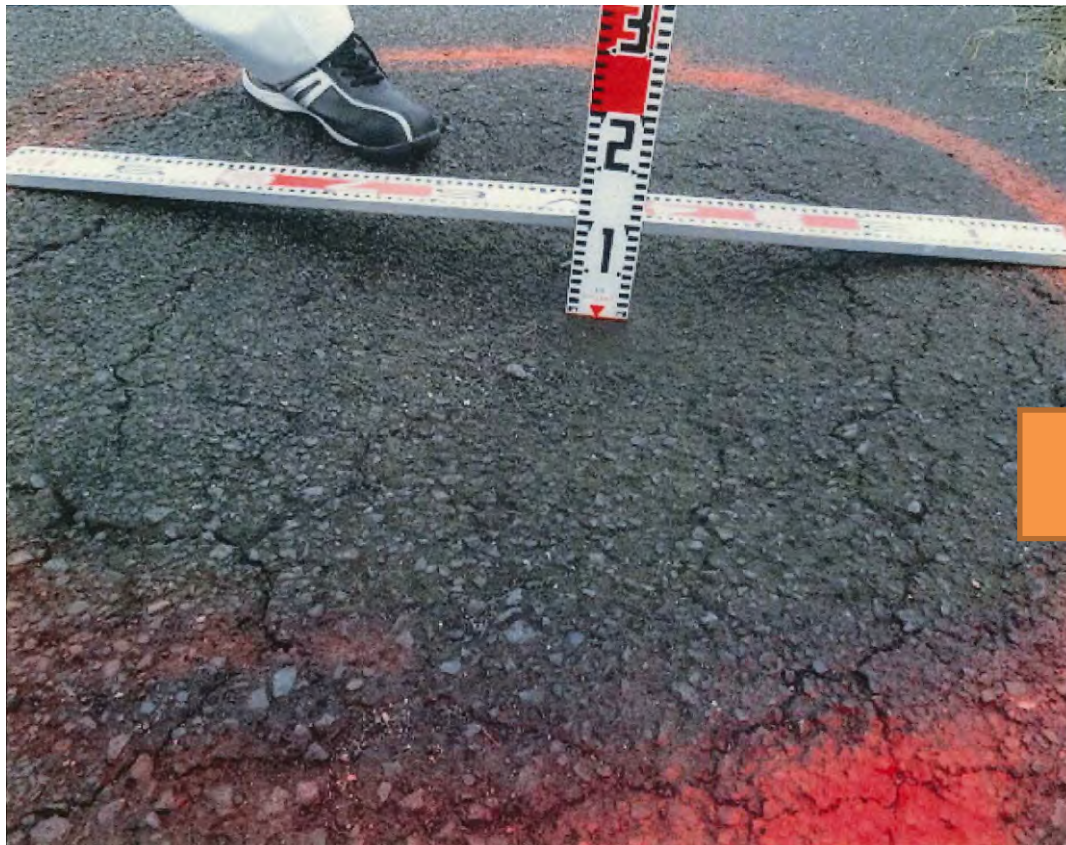
堤防天端アスファルト舗装の沈下を発見 半径:約90cm 深さ:約10cm(H27.8.31)
