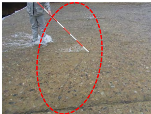
水叩き工表面に見られる亀裂
