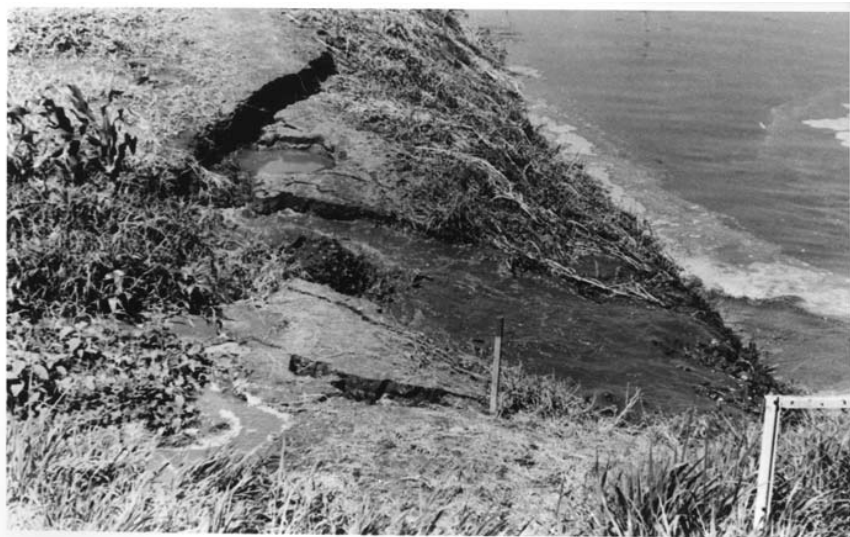
川表法面陥没
