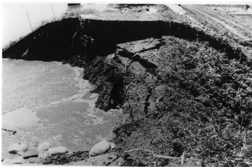
川表法面陥没増大、堤防全体の陥没が始まる
