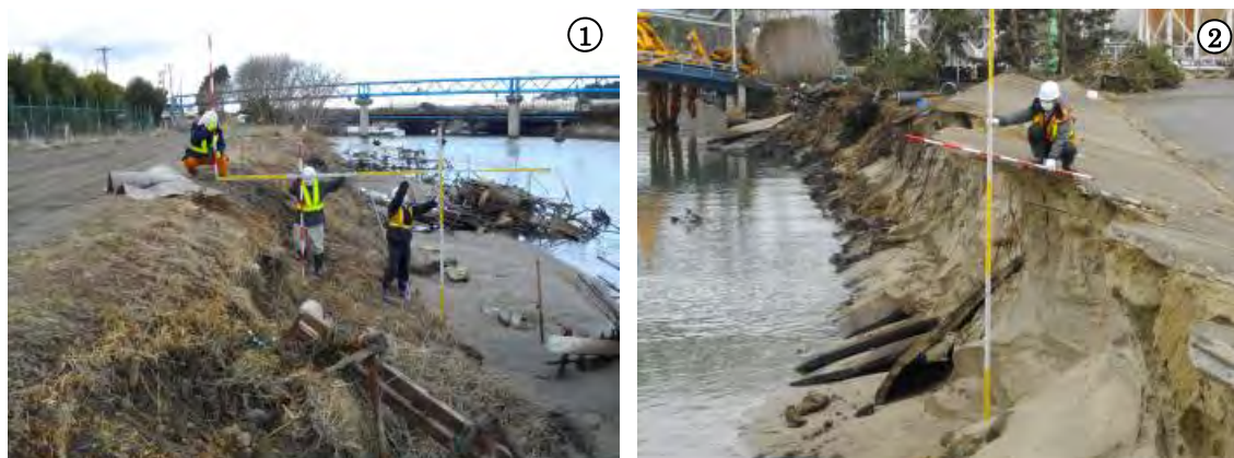
砂押川護岸の被災状況
