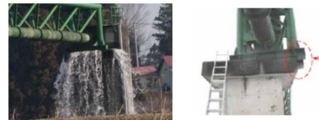
東日本大震災時の破損状況 【水管橋の破損：大崎広水】
