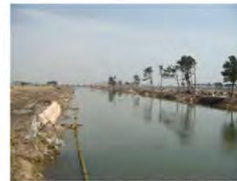
堤防の被災・流出 (南貞山運河)
