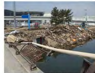
被災した橋梁 (南貞山運河)
