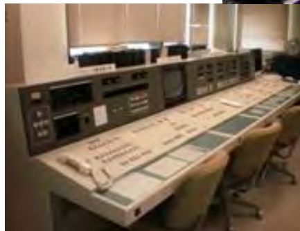
ダム管理用制御処理設備更新
