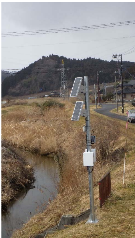
監視カメラ 設置状況（新川）
