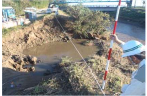
砂押川の破堤状況
