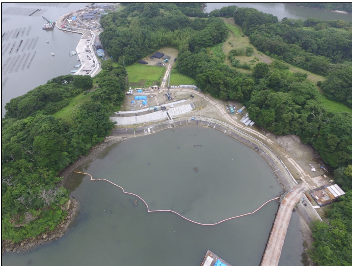
朴島1海岸の状況（令和2年7月20日）
