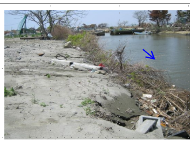
2. 堤体浸食（表） タイプB・L=130m
