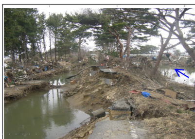
1. 堤体崩壊（裏） タイプA・L=120m
