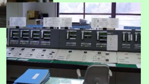
管理設備: 宮床ダム
