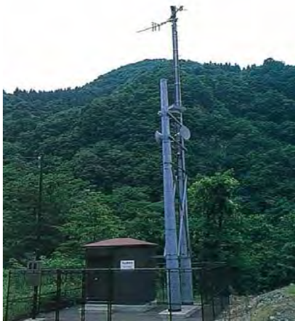
警報設備 (他ダム事例)
