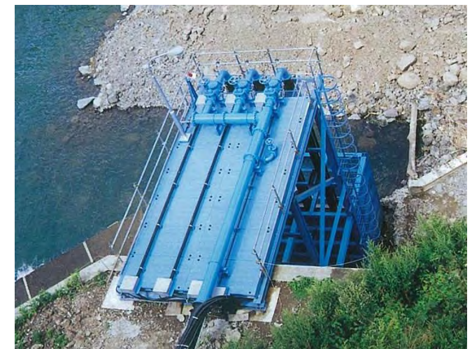
給水設備(他ダム事例)
