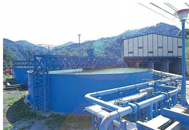
濁水処理設備(他ダム事例)
