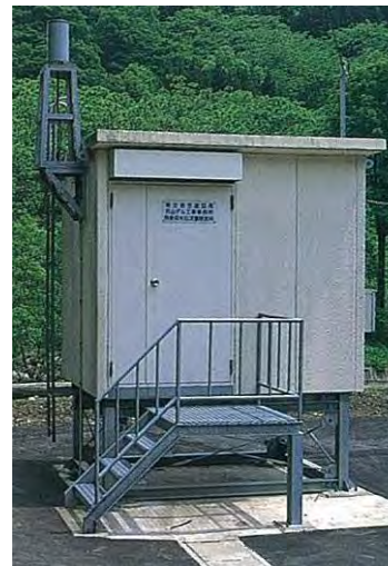
水位観測所 (他ダム事例)
