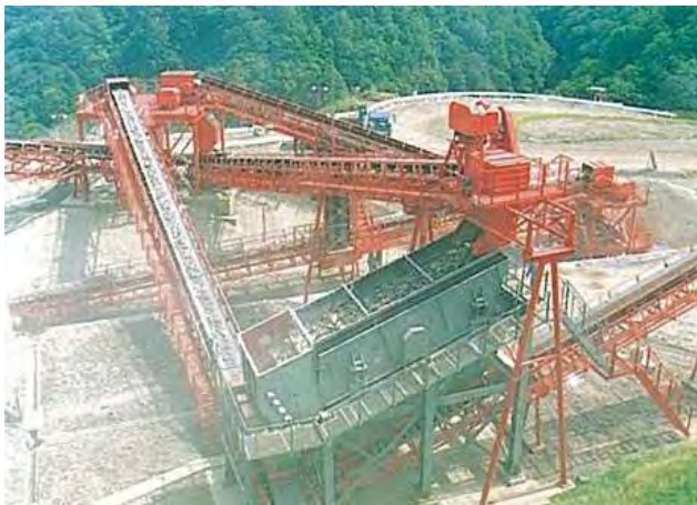
破碎設備(他ダム事例)
