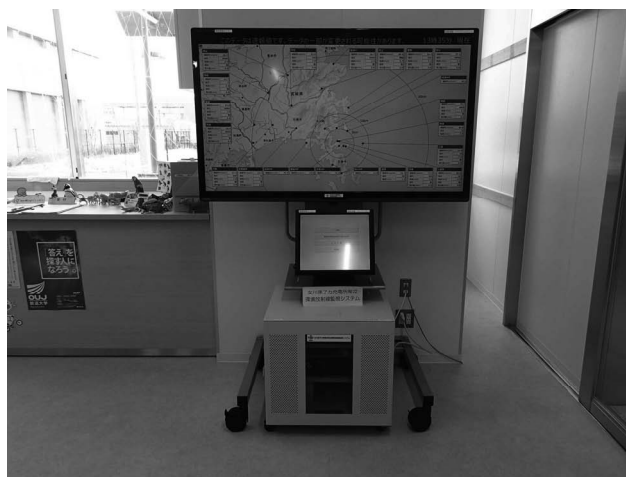
図5 副監視盤(宮城県環境情報センター内設置)
