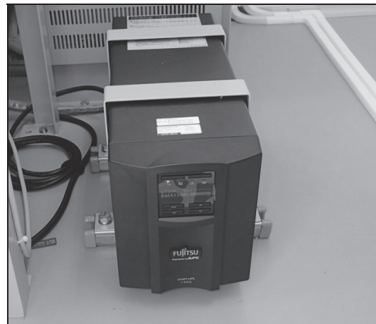
図 19 無停電電源装置
